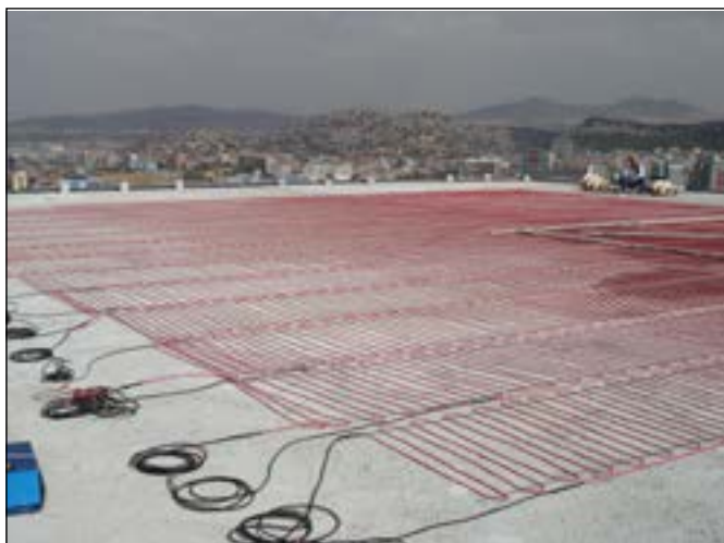
Система снеготаяния на вертолетной площадке Турция, Ego Center
